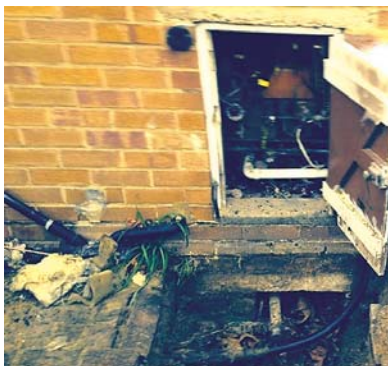
В тази дупка в стената бяха монтирани и електромери, и водомери, и газметри...
